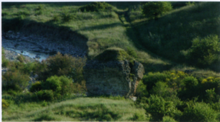
Resti del Ponte di Santo Spirito sul torrente Ginestra
