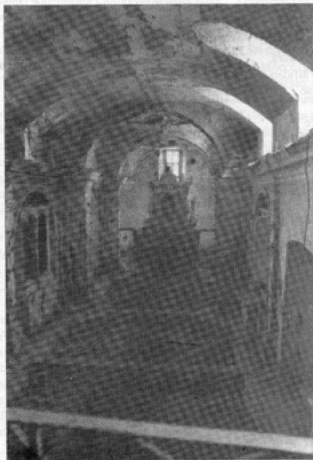
Andretta. Santuario di S. Maria del Mattino. Restauri (sospesi) per la riparazione dei gravi danni procurati dal terremoto del 23 nov. 1980 (foto A.M. Cafazzo)
