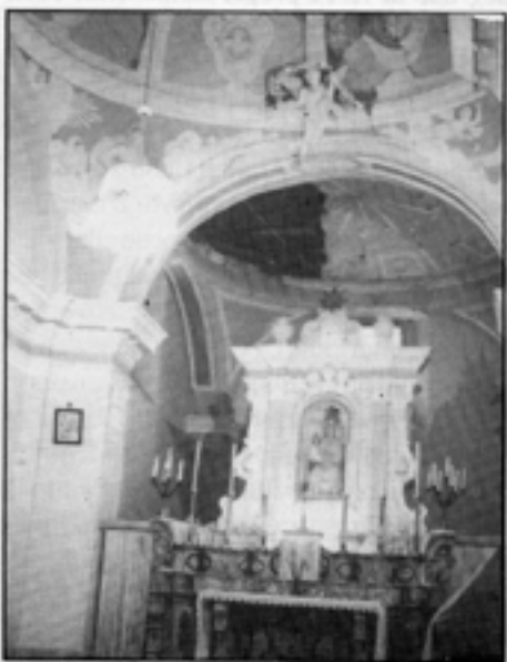
Andretta. Santuario di S. Maria del Mattino. Distacco di parte della volta della cupola provocato dal terremoto del 1980.
