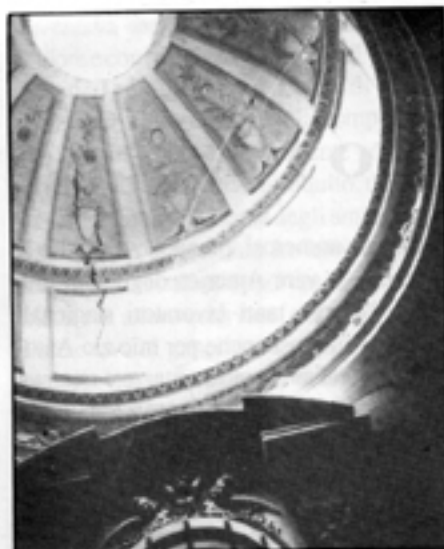
Andretta. Chiesa Madre. Lesioni nella cupola della cappella di S. Antonio di Padova provocate dal terremoto del 1980.
